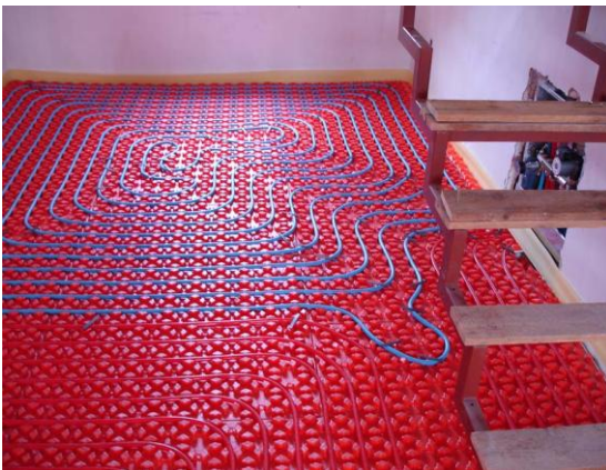
Θέρμανση – Ψύξη – Κλιματισμός
