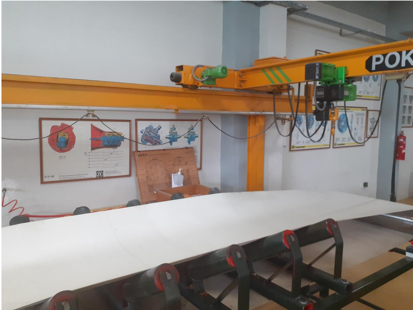
Γερανογέφυρα και ταινιόδρομος
